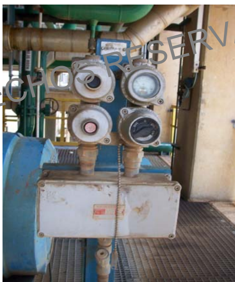
Figura 10. Medidor de flujo de Agua de Enfriamiento.
