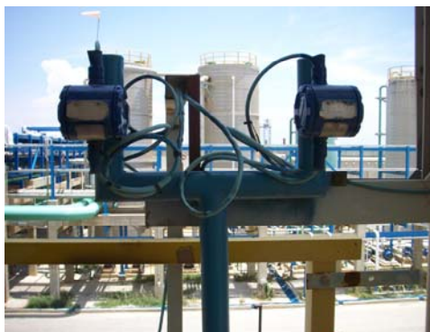
Figura 13. Medidor de Temperatura
