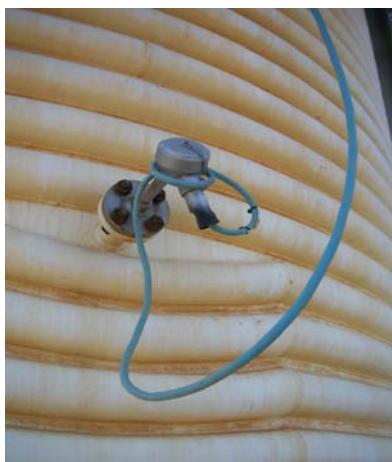
Figura 12. Conexión de sensor RTD a la chaqueta del reactor. Modelo 3144.
