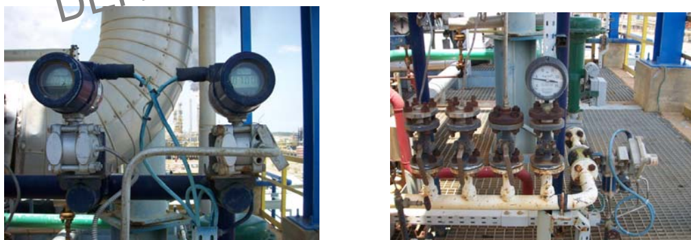
Figuras 11. Medidores de Presión en el Reactor de Polimerización
